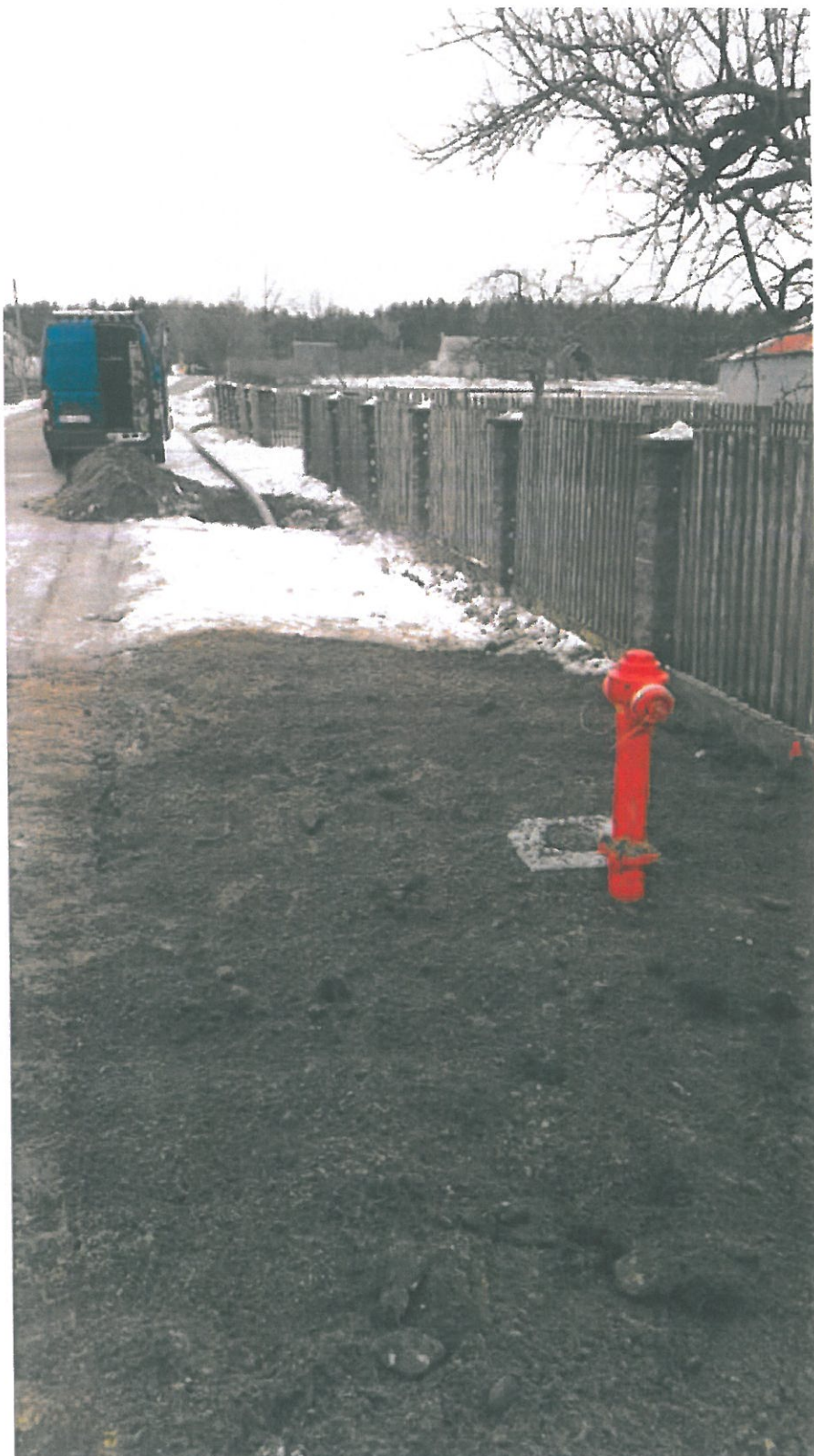
Budowa sieci wodociągowej w m. Brzozowy Kąt i Rutkowo wraz z przyłączami
